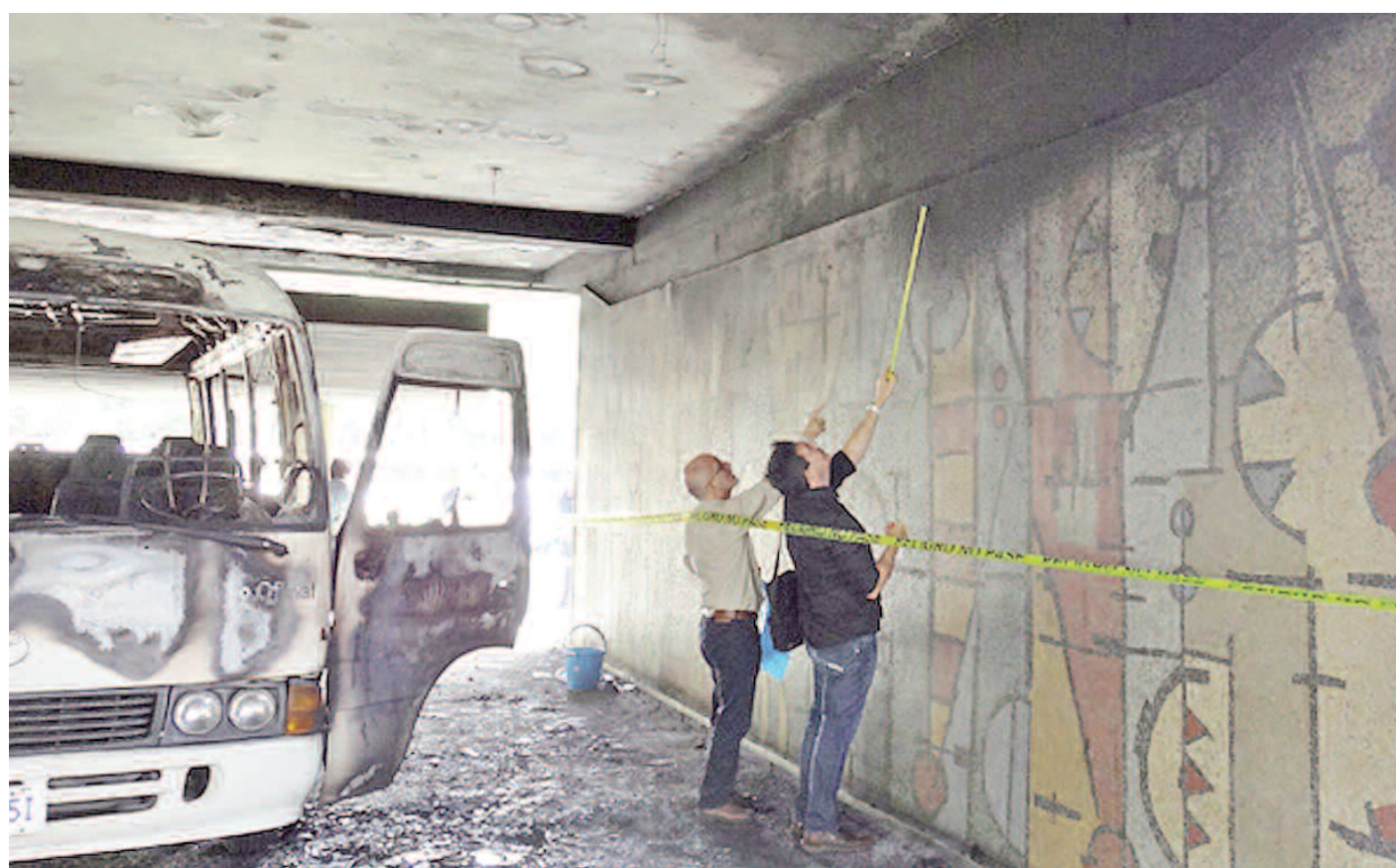
El fuego originó severos daños en la losa, vigas y columnas del edificio
