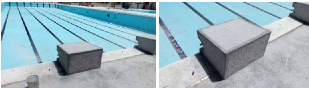
Estado actual se están realizando el acabado de concreto martillado en los tacos de la piscina olímpica
