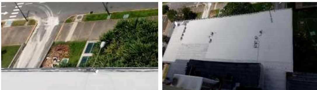
Vista de la losa ya impermeabilizada y se le colocó su pintura pinturas asfálticas color gris cemento
