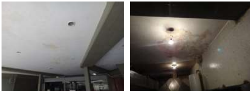
Filtraciones en la zona de cocina y mesas
