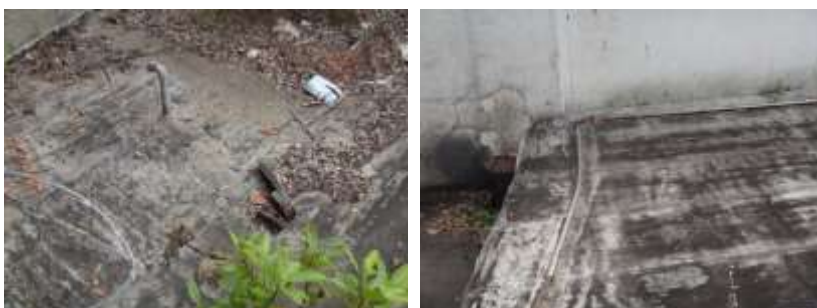
Escombros y restos vegetales
