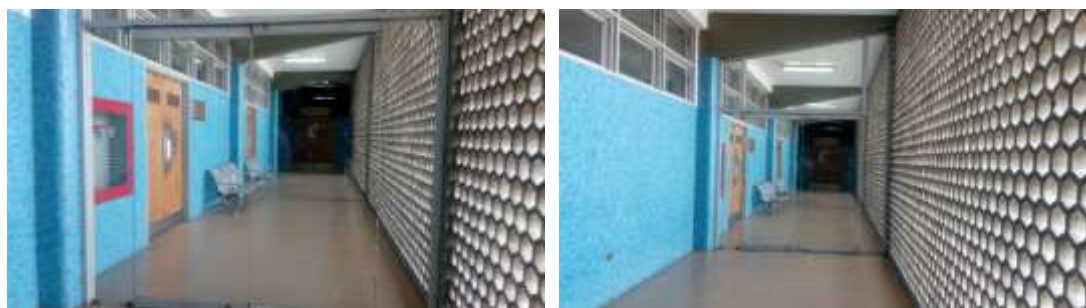
Instalación de puerta de vidrio templado desmontado del Hall del Edificio del Rectorado
